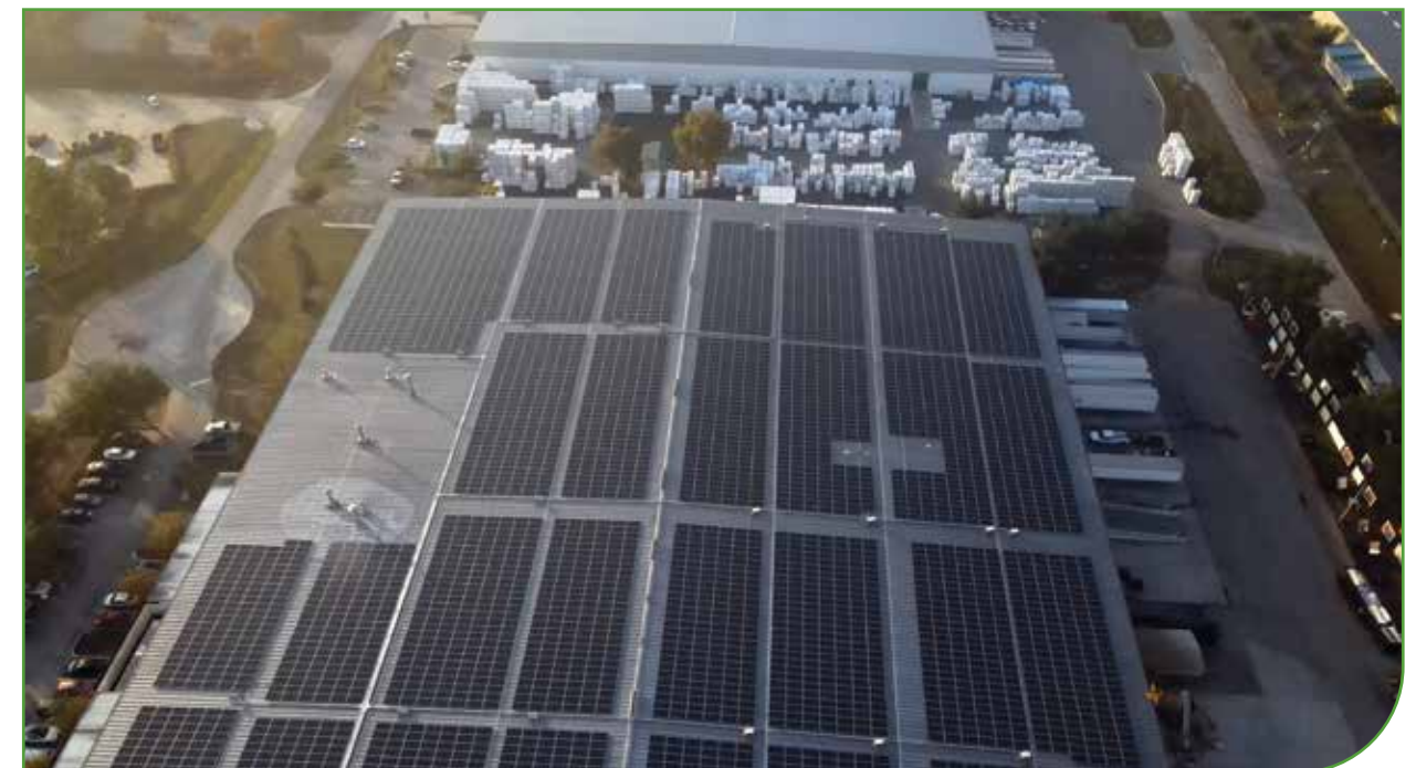
Paneles solares en el techo de la planta de Brooksville, Florida
